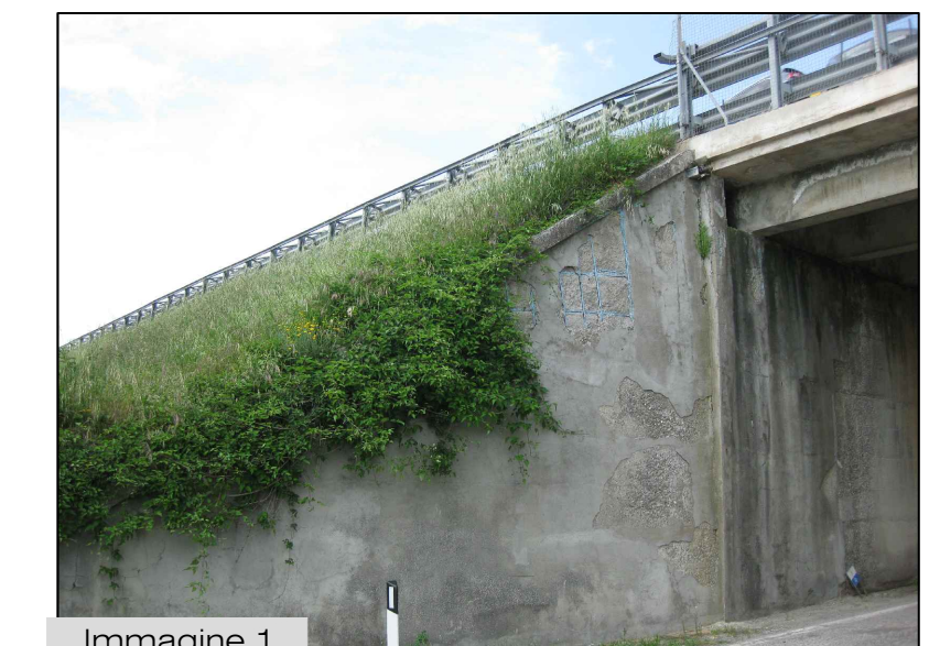
Immagine 1 Portale 2 lato Napoli, coronamento degradato, armatura scoperta, rimozione vegetazione
