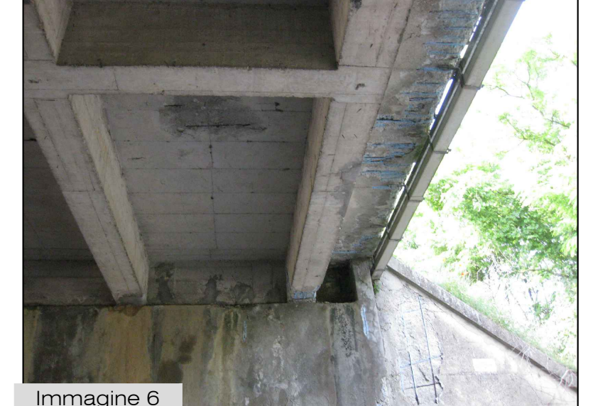
Immagine 6 Portale 1 lato Milano, degrado del calcestruzzo e armatura scoperta
