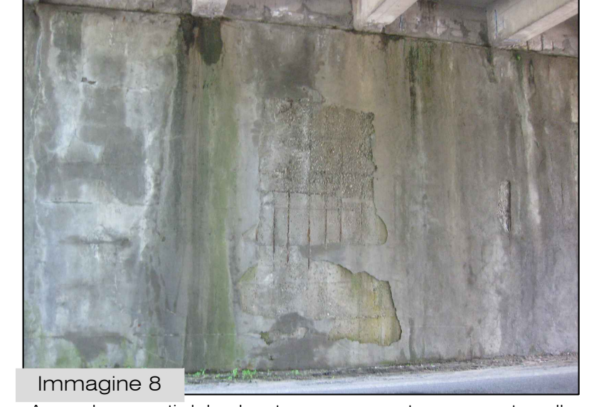
Immagine 8 Ammaloramenti del calcestruzzo e armatura scoperta sulle pareti
