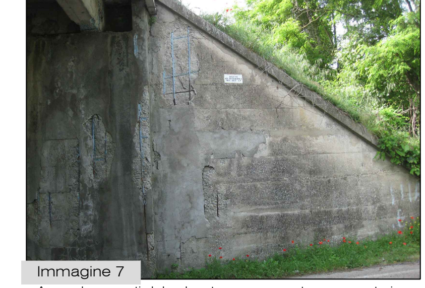
Immagine 7 Ammaloramenti del calcestruzzo e armatura scoperta in corrispondenza del giunto d'ala lato Milano
