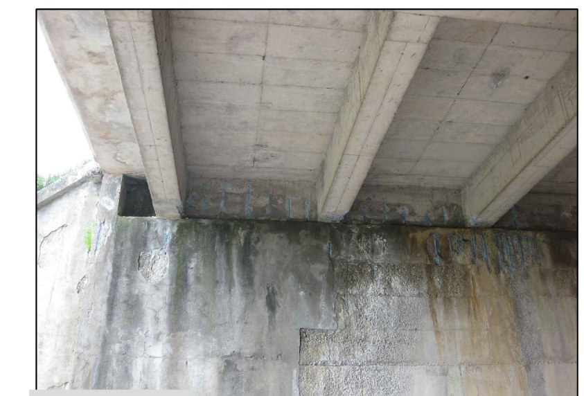
Immagine 3 Ammaloramenti del calcestruzzo e armatura scoperta sulle pareti e sulle travi longitudinali di bordo
