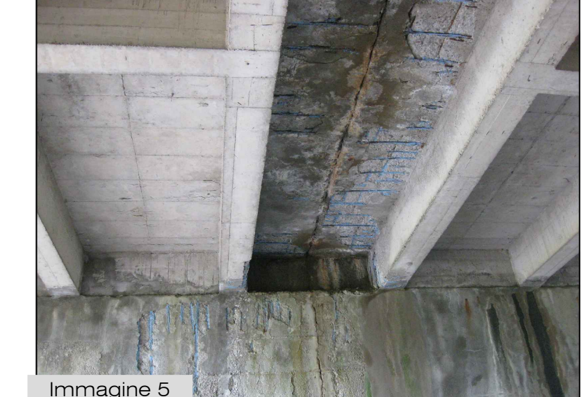
Immagine 5 Ammaloramento del calcestruzzo e armatura scoperta in corrispondenza del giunto sulla soletta
