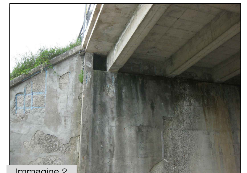
Immagine 2 Trave di bordo lato Napoli, ammaloramento cls scoperto, rimozione vegetazione
