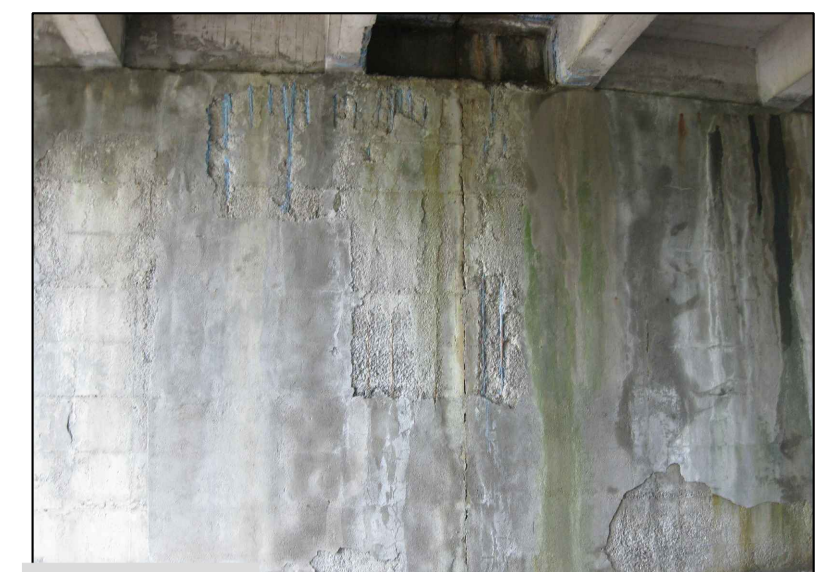
Immagine 4 Ammaloramenti del calcestruzzo e armatura scoperta sulle pareti in corrispondenza del giunto
