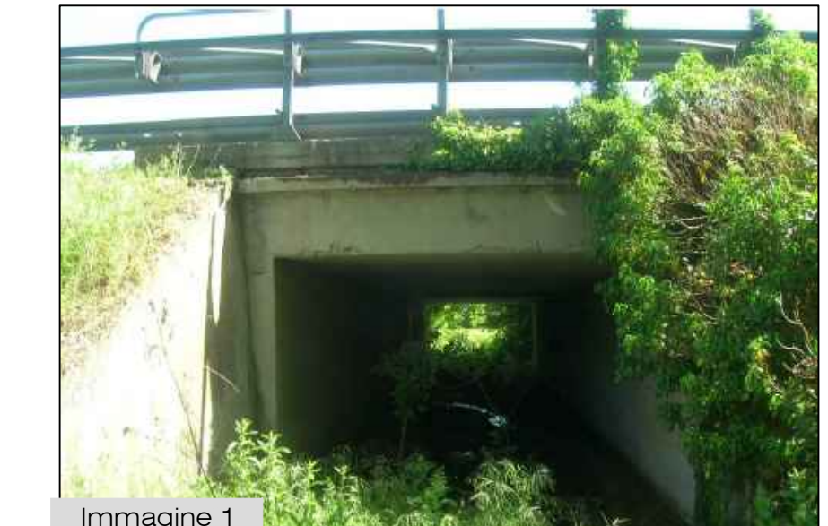
Immagine 1 Portale 1 direzione Milano, coronamento degradato, spigoli con armature scoperte e prevedere la rimozione della vegetazione
