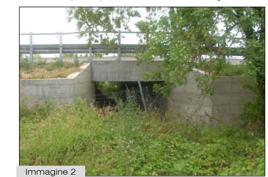
Immagine 2 Portale 2 direzione Napoli, ammaloramenti del calcestruzzo
