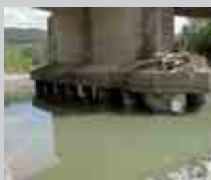
Scalzamento fondazione Opera Idraulica maggiore località Tevere Giove [€ 860.000] Situazione ante operam
