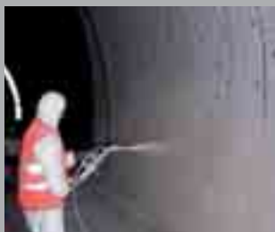
Impermeabilizzazione di piedritti mediante un sistema accoppiato composto da teli in PVC
